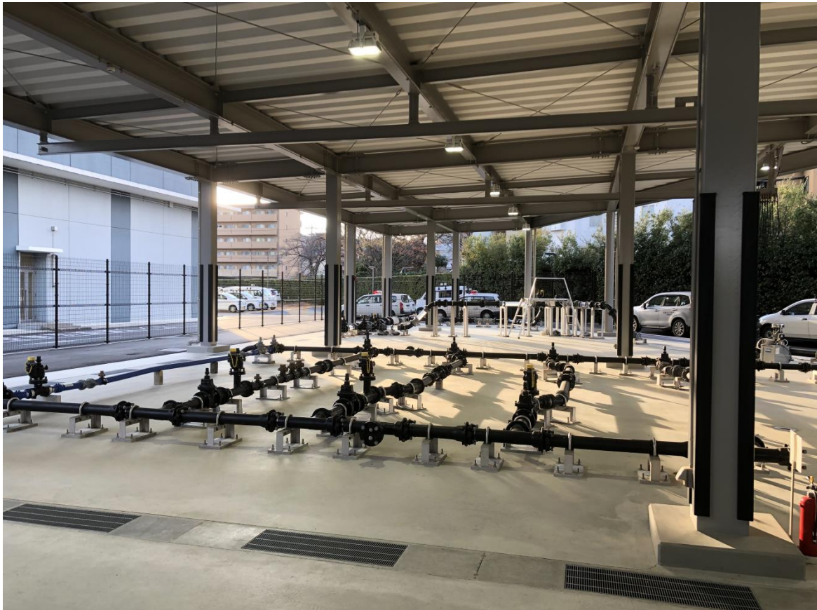
研修施設の見学（写真は露出配管ですが、埋設配管の施設もあります）
